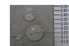
ひび割れ部ではつ水状況
