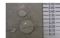
ひび割れ部ではっ水状況
